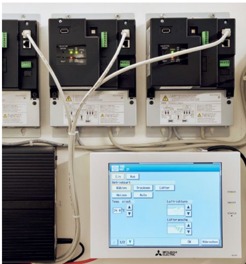
Mit einem System alles im Blick: Mit der AE-200E lassen sich die angeschlossenen Innengeräte zentral überwachen und steuern.
